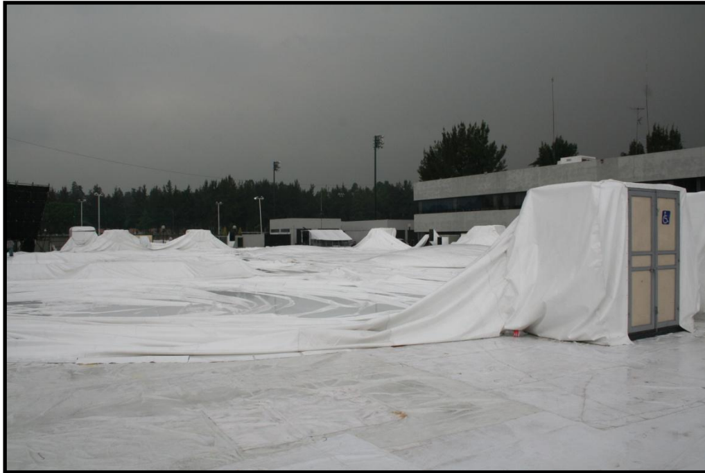
Imagen 11. La carpa neumática no contaba con estructuras fijas para soportar sus muros o techo.
