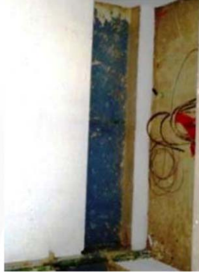
Foso de montacargas en Sótano 1
